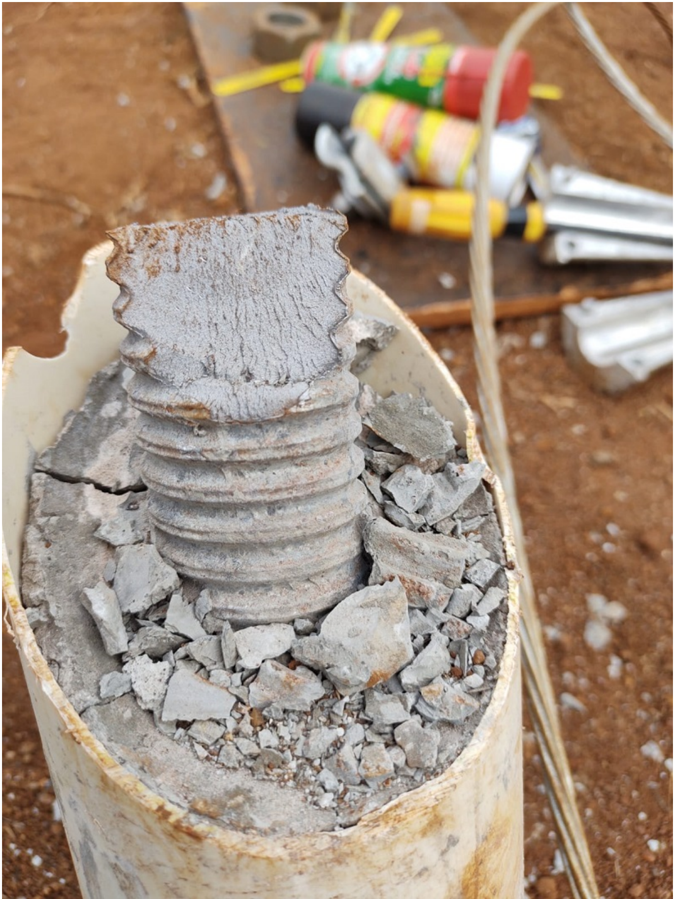
Aí parece que serraram os chumbadores dos pés das torres (Foto:Via WhatsApp)
